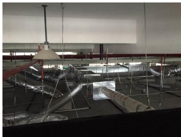
图 7.7-2 回流炉废气、固化废气集气装置
